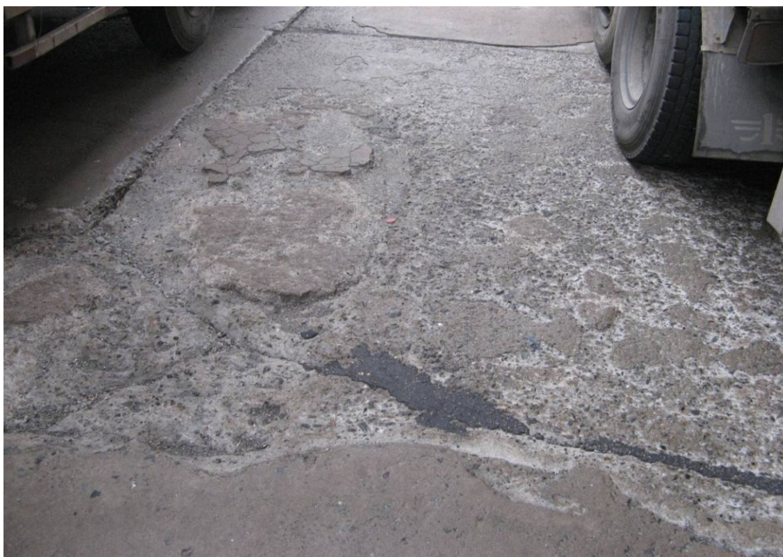
图 2-46 服务区混凝土路面破损
