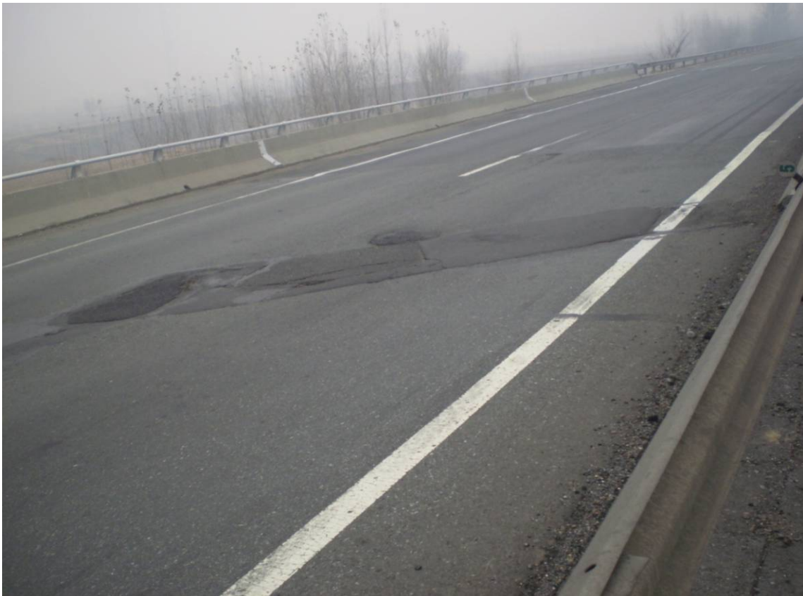
图 2-27 桥面沥青混凝土破损
