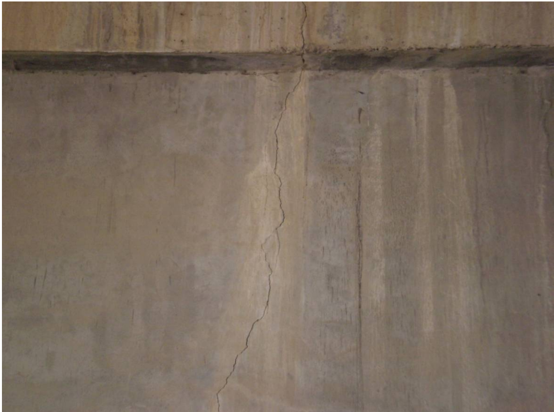
图 2-24 通道轻台竖向裂缝
