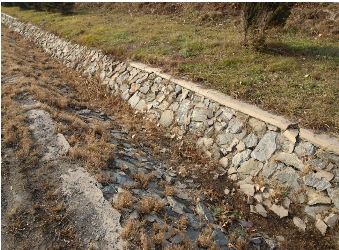
图 2-10 浆砌边沟破坏
