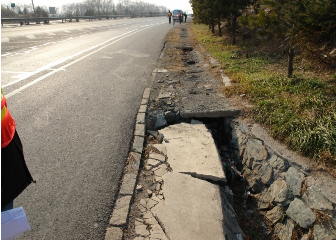
图 2-9 路肩盖板破坏
