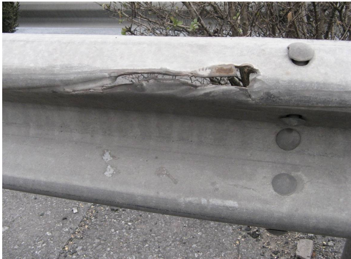
图 2-39 波形梁板破坏
