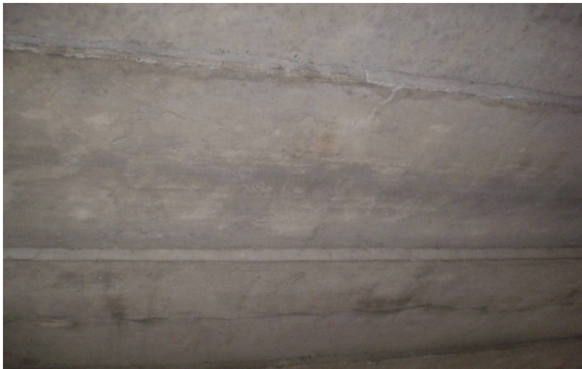
图 2-22 主梁纵向裂缝
