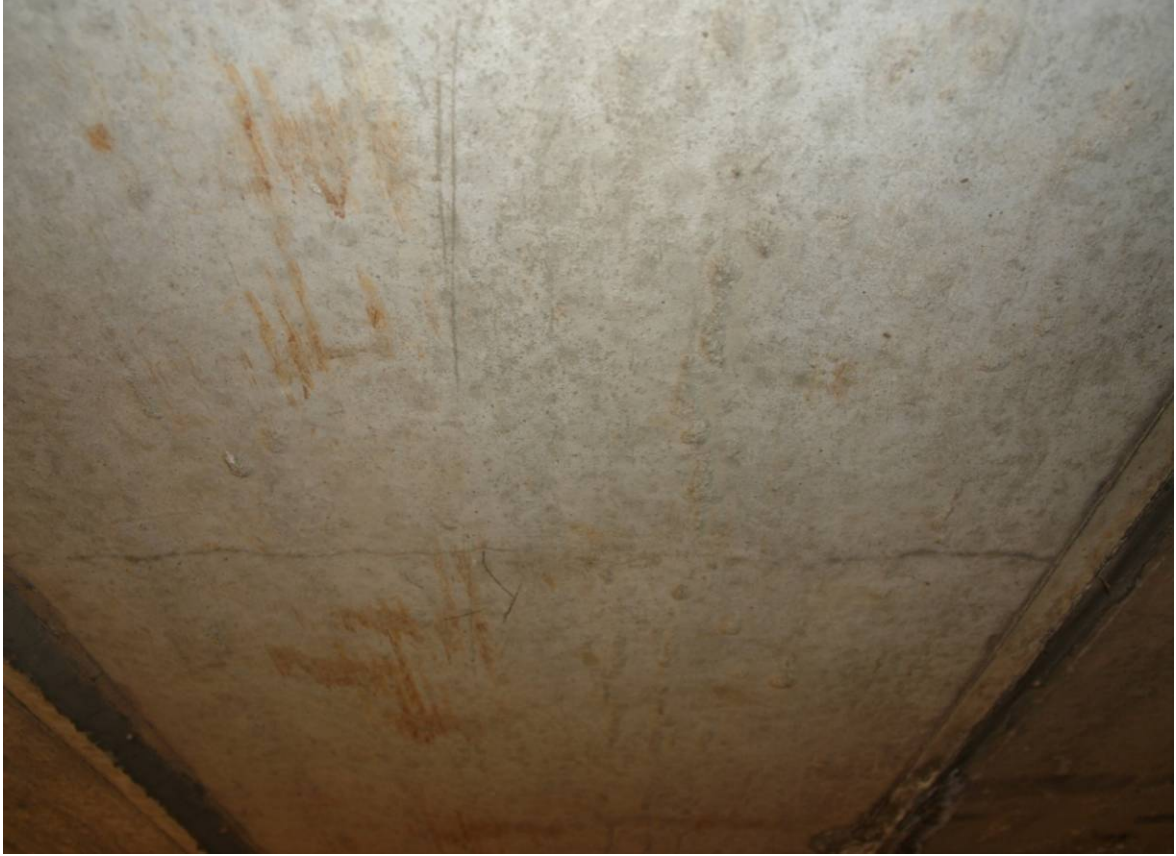
图 2-23 主梁横向裂缝
